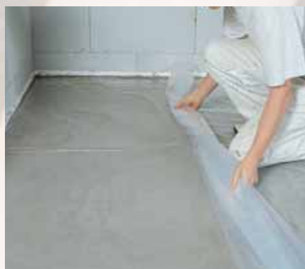
Der monteres kantisolering langs vægge. Den svømmende konstruktion kan udlægges på 2 lag 0,15 mm. PE-folie.
