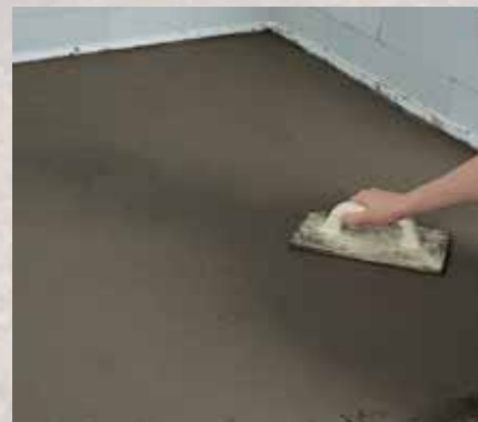
Efter endt udlægning af pudslaget afspærres arealet indtil pudslaget er tilstrækkeligt afbundet.
